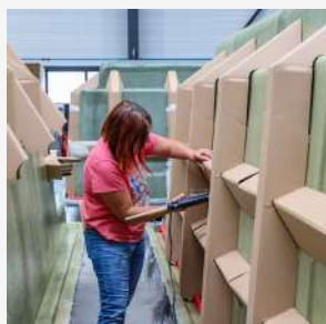
5. Mise en place des pré-formes de renfort pour la stabilité du bassin
